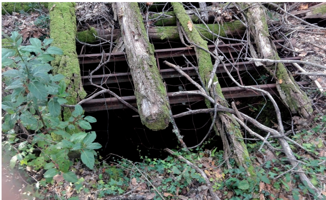
Il pericoloso ingresso al pozzo.
